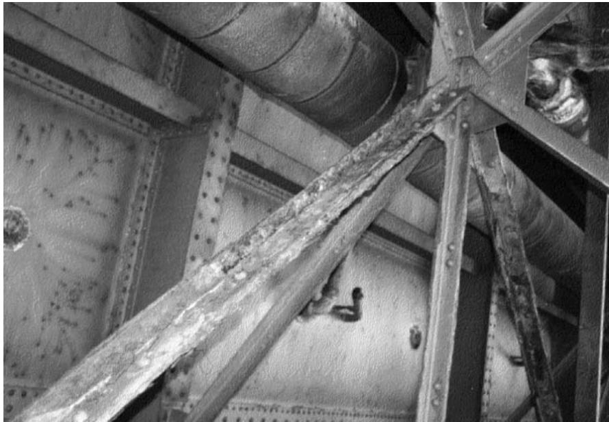
Bild 5.4: Schadensbild an den oberen Verbänden (Auszug aus Hauptprüfbericht)
