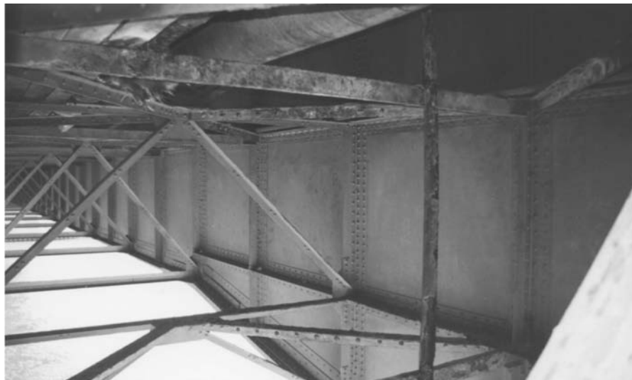
Bild 5.3: Schadensbild der Verbände zwischen Hauptträgern B und C (Auszug aus Hauptprüfbericht)
