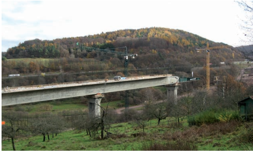
Bild 1.10: Kauppenbrücke über die Kleinaschaff im Zuge der A 3 - Taktstücken, Foto: ABD Nordbayern
