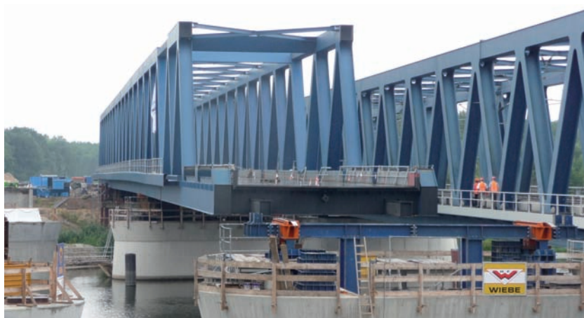
Bild 1.52: EÜ Havelbrücke Rathenow (links) beim Vorschub, rechts die HGV-Strecke, Foto: Schüßler-Plan Ingenieurgesellschaft mbH, Berlin
