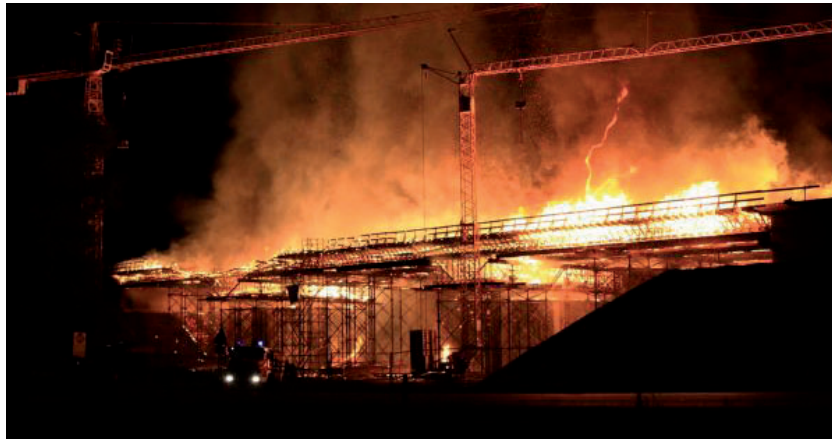
Bild 1.32: Brücke über das Fischbachtal im Zuge der B 101 bei Großschirma - Brand der Schalung durch Fremdeinwirkung, Foto: SBA Chemnitz
