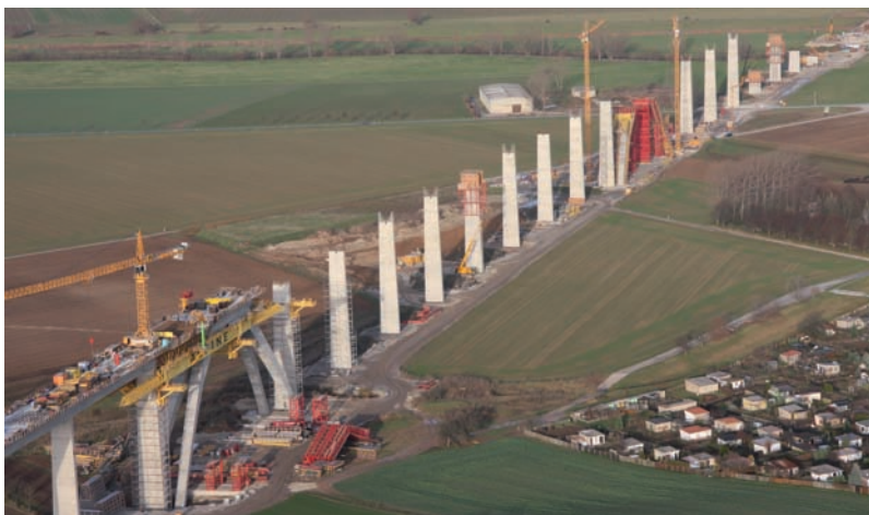
Bild 1.22: Unstruttalbrücke im Zuge der NBS Erfurt - Halle/Leipzig - Blick Richtung Westportal Osterbergtunnel, 1. und 2. Bogen im Bau, Foto: DB AG
