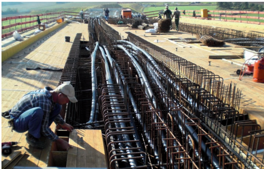
Bild 1.13: Brücke über die Kleine Laaber im Zuge der B 15n - Spanngliedverlegung im Überbau der RF Landshut, Foto: ABD Südbayern
