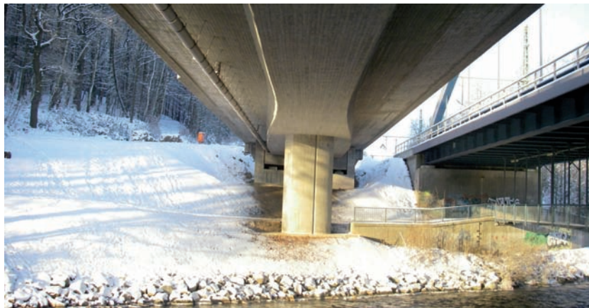
Bild 1.36: Brücke über die Zschopau - Verjüngung des Mittelträgersteges im Mittelfeld, Foto: DEGES/VIC GmbH
