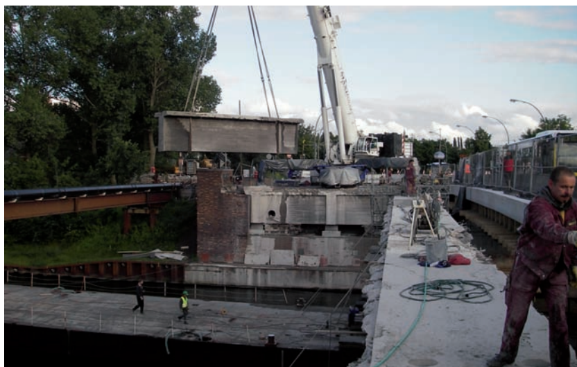
Bild 1.57: Ludwig-Hoffmann-Brücke über den Westhafen-Kanal in Berlin-Mitte - Abbruch der Spannbeconlängsträger, Foto: VIC BB GmbH
