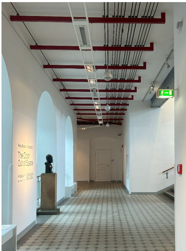
Abb. 37 Decke mit elektrischen Leitungen (Alexa-Joelina Mammitzsch 2023)
