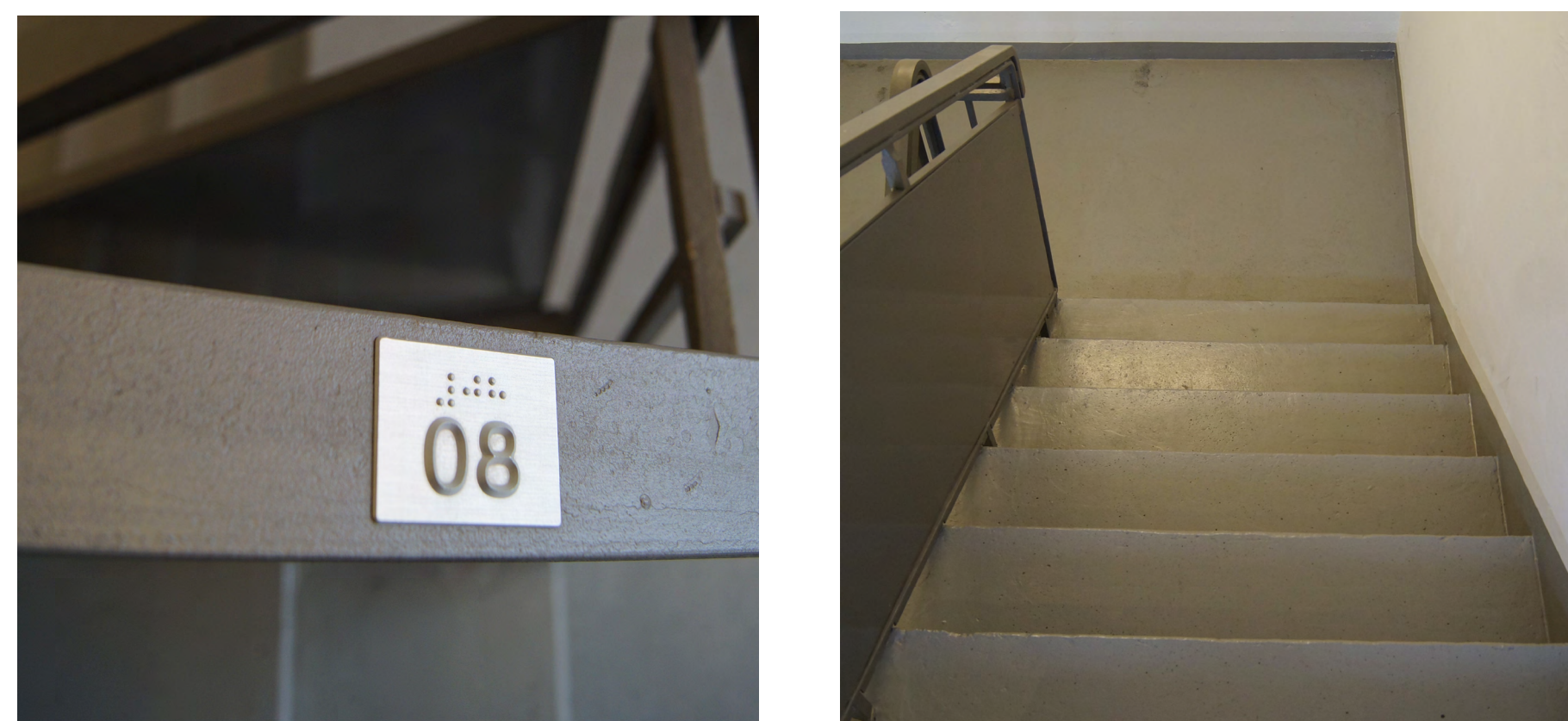
Abb. 4: Taktile Handlaufbeschriftung, aber keine Treppenstufenmarkierungen, Gret-Palucca-Straße 9.
