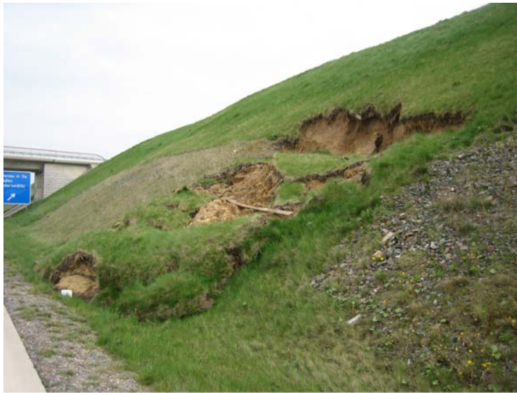
Abbildung 1: Rutschung einer Böschung eines Lärmschutzwalls nach Starkregenereignissen
