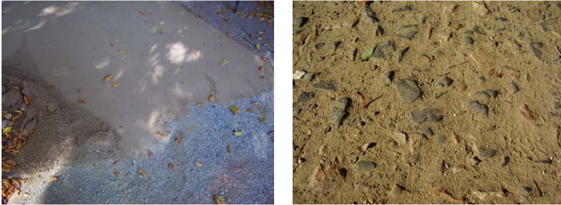
Abbildung 4: Oberflächenbefestigung wassergebundener Parkwege, links: Neubau, rechts: abgenutzte Oberfläche
