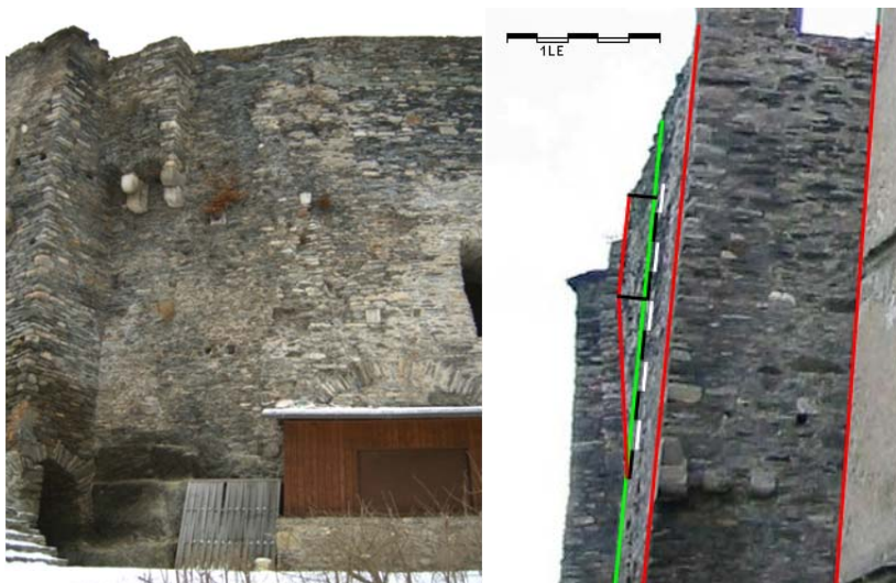
Abbildung 2.2: Schlossmauer vor dem Teileinsturz [Dr. Wehr] (links) Abbildung 2.3: Detailbild Abschätzung Neigungswinkel (rechts)
