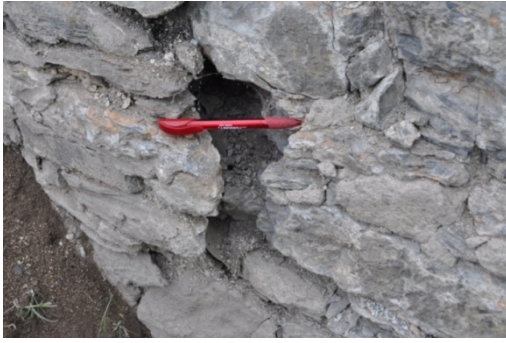
Abbildung 2.4: Abgelöste Scheiben an der Mauerwerksoberfläche
