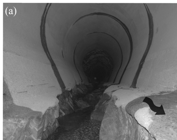
Abb. 1: Hydroabrasion im Sedimentumleitstollen Palagnedra
