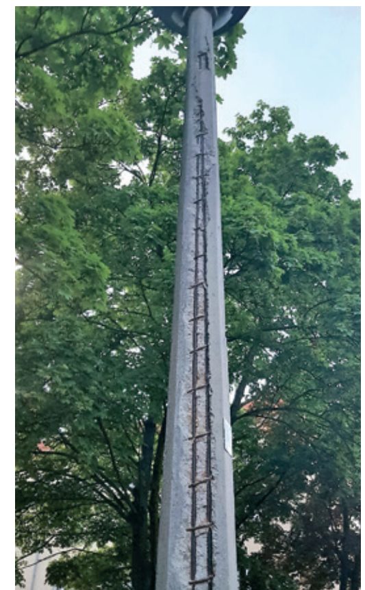
Längsrisse und Abplatzungen an einem Spannbetonmast | Foto: Patrick Koreng
