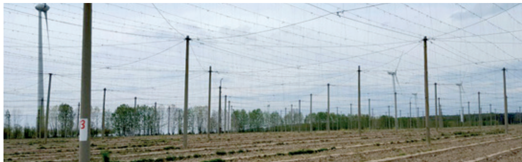
Spannbetonmaste | Foto: Patrick Koreng
