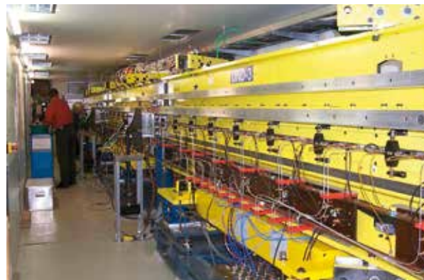
Undulator nach Einbau in den Beschleuniger
