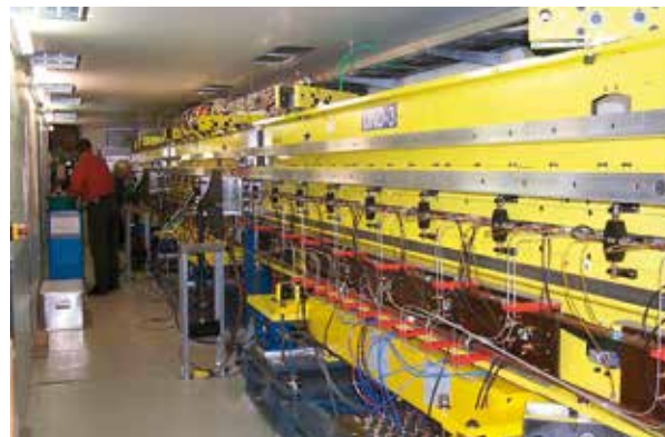
Undulator nach Einbau in den Beschleuniger
