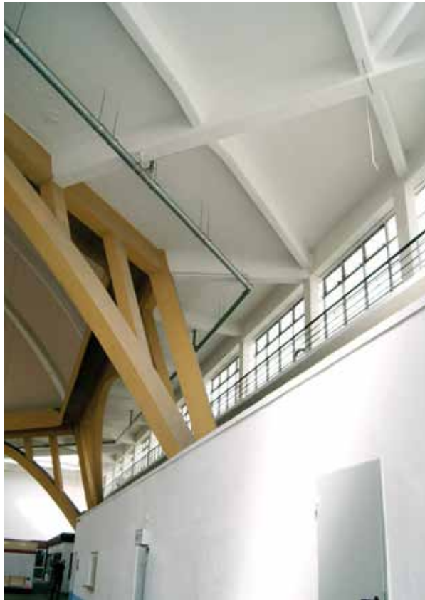
Untersicht einer Zwickeldecke mit dem Hauptunterzug und den Nebenunterzügen (Foto: Jürgen Stritzke)
