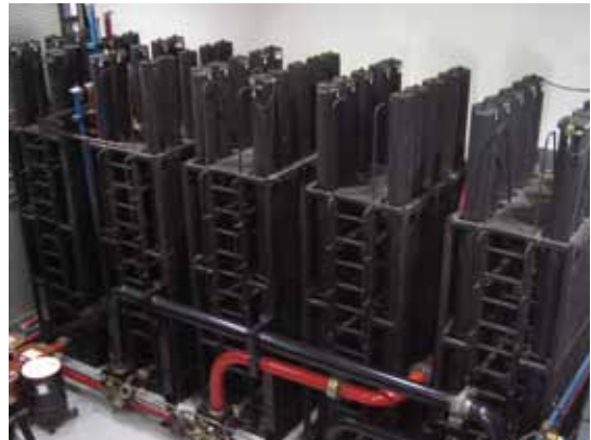
Riesige Stickstoffbatterie zum Speichern der hydraulischen Energie Huge Nitrogen Battery for Storage of Hydraulic Energy
