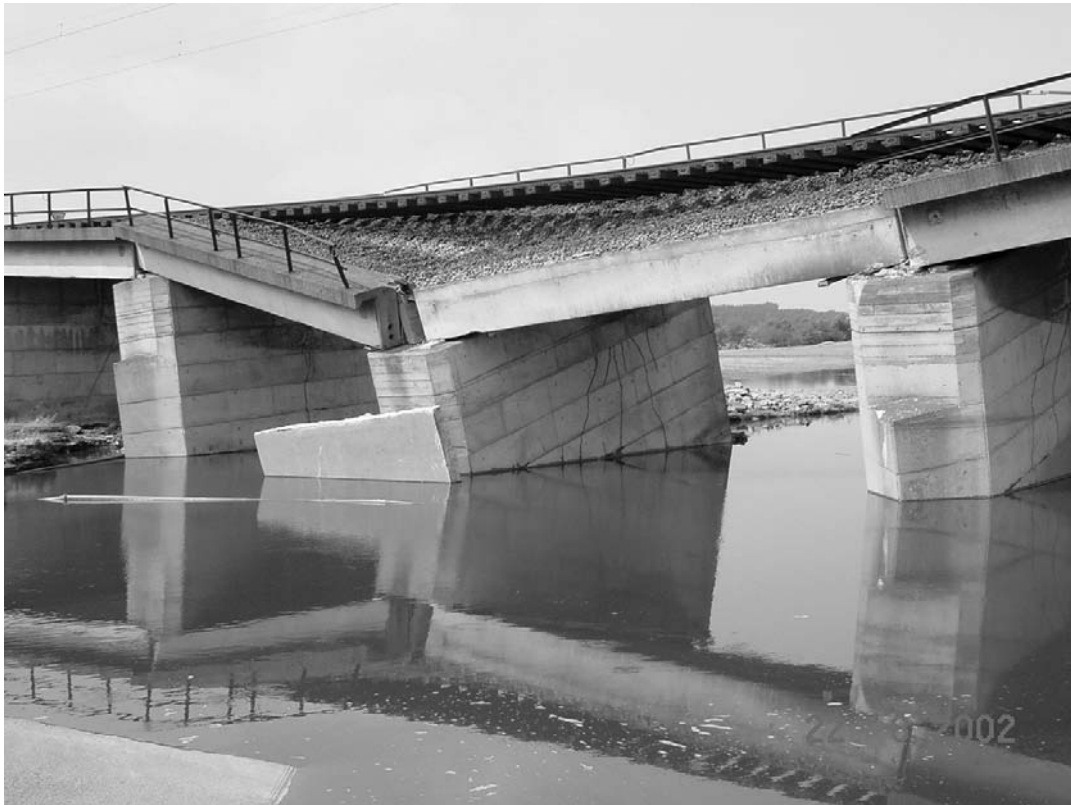
Bild 9.1: Schäden Viadukt I
