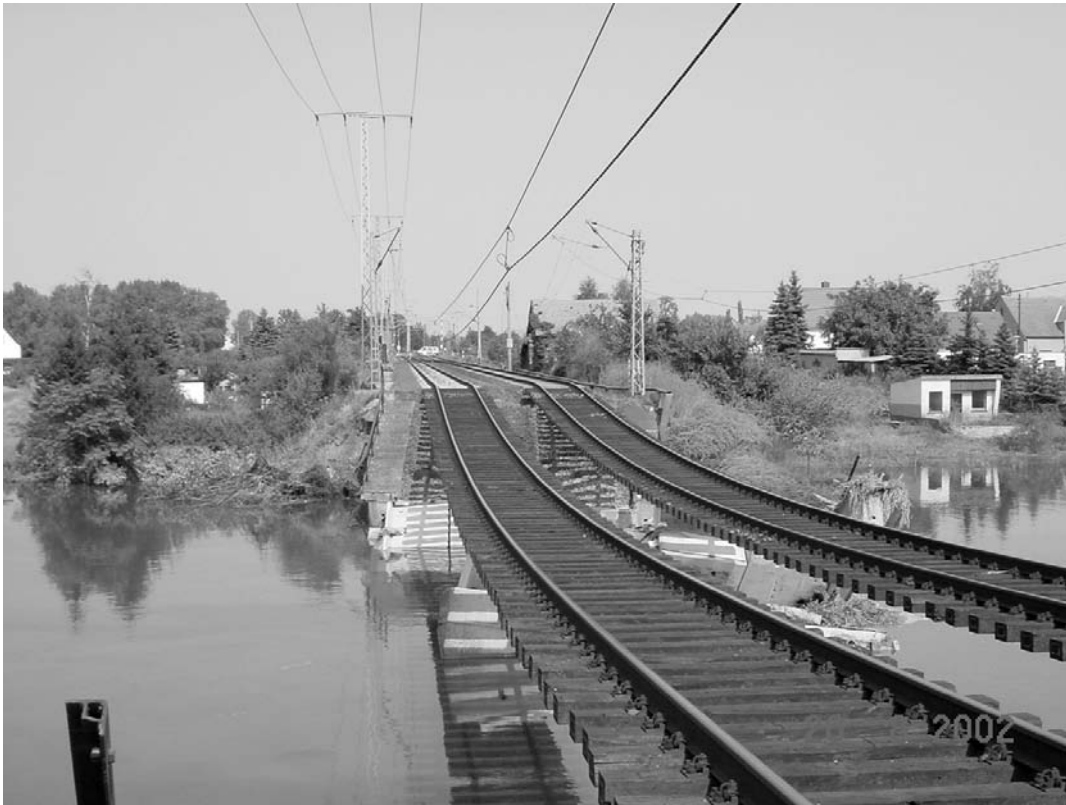
Bild 9.2: Schäden Viadukt II
