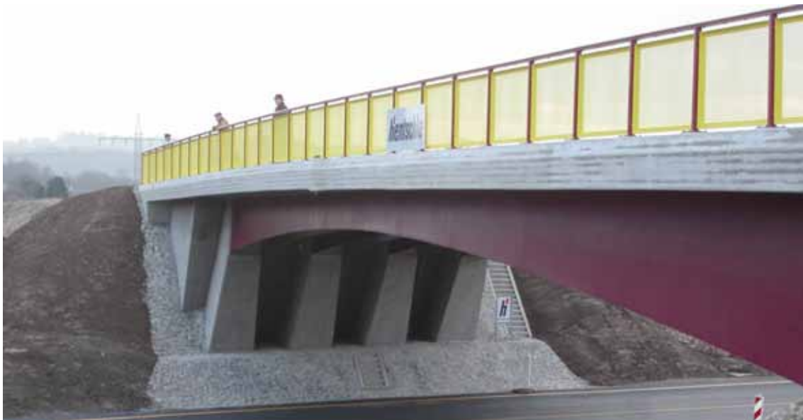
Bild 11.1: Überführung der B 4 über die A 73 in der Nähe von Coburg – Rahmenbrücke in Verbundbauweise (Quelle: GMG Ingenieurpartnerschaft)
