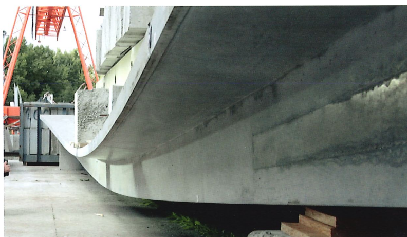
Bild 6.19: Verformung des Brückenfertigteils: Längsansicht
