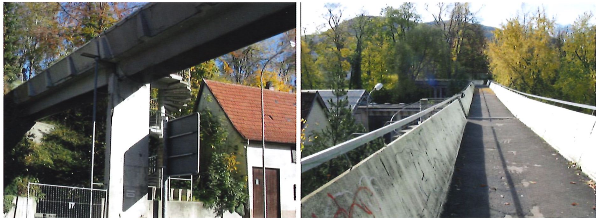
Bild 6.2: Ursprüngliche Fußgängerbrücke in Albstadt mit Korrosionsschäden [Foto: Groz-Beckert]
