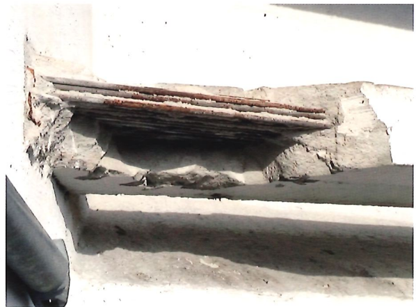
Bild 8.18: Detail eines Trägers nach der lokalen Entfernung des schützenden Betons 2014 (Foto: Luc Taerwe)
