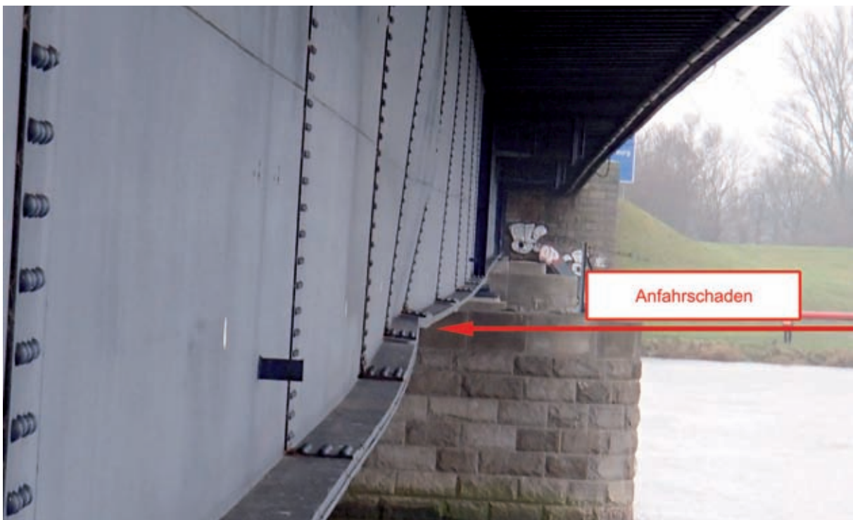
Bild 5: Anfahrtschaden, Ansicht aus Süden
