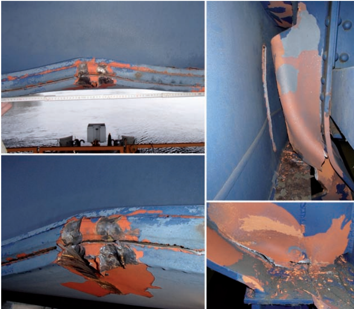
Bild 4: Schäden an Flansch und Aussteifungselementen
