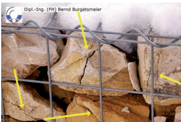
Bild 15: Frostschaden an ungeeignetem Füllmaterial eines Steinkorbes [32]
