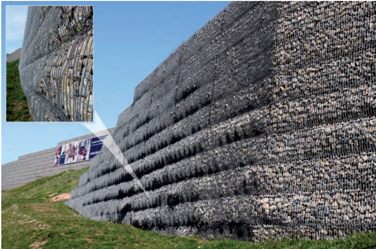
Bild 16: Verformungen an der Front einer KBE mit gabionenartigem Facing
