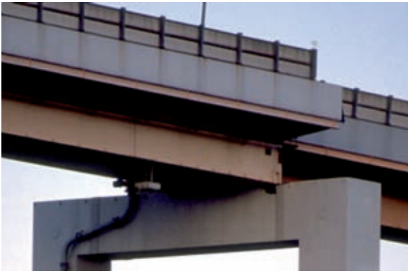
Bild 2: Seitlicher Versub eines Brückenträgers durch das 1995er Kobe-Erdbeben (Foto: Thomas Wenk, [18])
