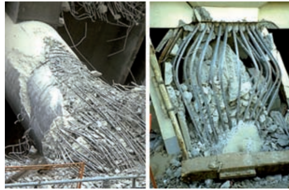
Bild 3: Versagen von Stahlbetonstützen einer Brücke beim 1995er Kobe-Erdbeben (Fotos: Thomas Wenk, [18])
