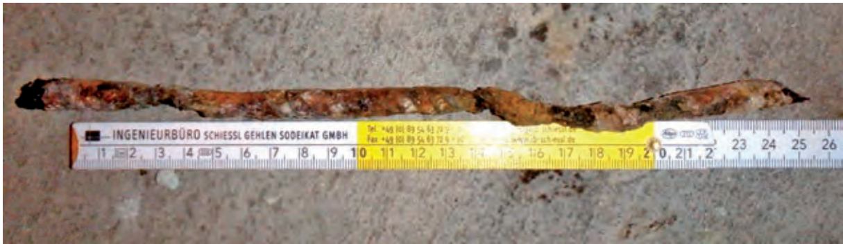
Bild 7 Aktive Bewehrungskorrosion in den Notgehwegen der Tunnelbauwerke Eching und Etterschlag Foto: Ingenieurbüro Schießl Gehlen Sodeikat GmbH
