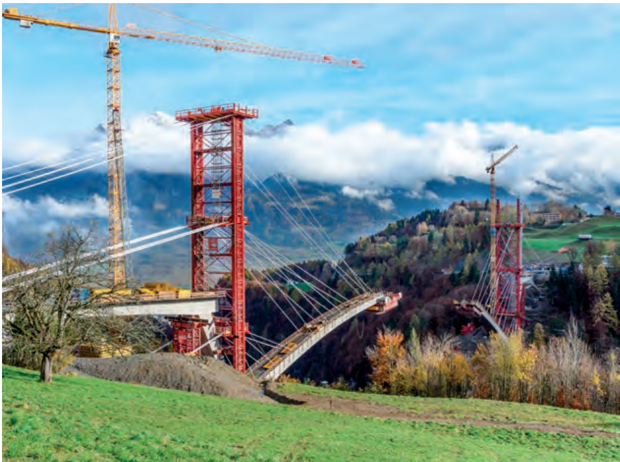
Bild 12 Freivorbau im Wochentakt; zu sehen sind die Hilfspylone und Abspannungen sowie rechts (Seite Pfäfers) der höchste freistehende Turmdrehkran Europas
