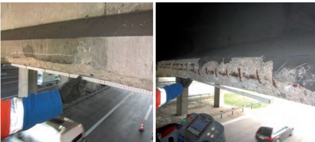
Bild 5 Schäden an den Stegen der Spannbetonträger über den Lkw-Spuren (AK München Ost, BW 17) Fotos: Autobahndirektion Südbayern
