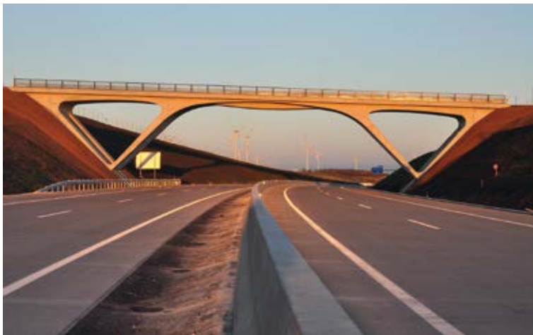
Bild 3 Beispiele materialoptimierter Überbauformen; von oben nach unten: An- und Untersicht der Überführung im Zuge der A3 in Wendlingen-Kirchheim, Überführung A5 Ü20 Grafiken: schlaich bergemann partner (oben u. mitte), © Dr. Michael Kleiser (unten)
