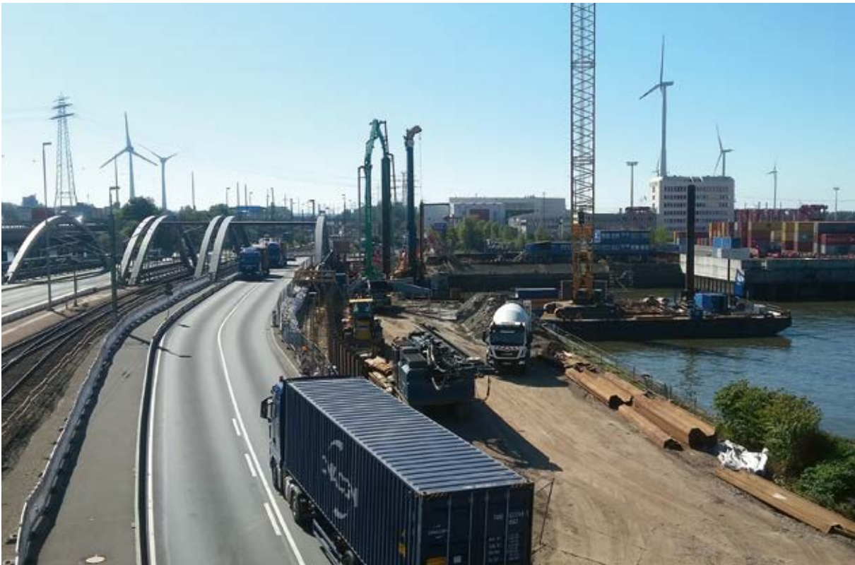
Bild 11 Bauphase 2, Stand der Bauarbeiten im November 2018. Drei der vier neuen Brückenüberbauten sind fertiggestellt und in Betrieb genommen. Die westliche Bahnbrücke (rechts) dient als Straßenbrücke für die provisorische Umfahrung. Die Widerlager für die westliche Straßenbrücke werden hergestellt. Foto: Thomas Witt / HPA
