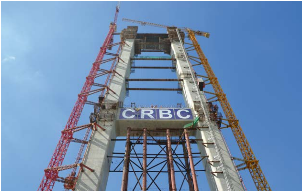
Bild 5 Pylon mit ca. 137 m Höhe mit dem unteren und oberen Querriegel im Bauzustand
