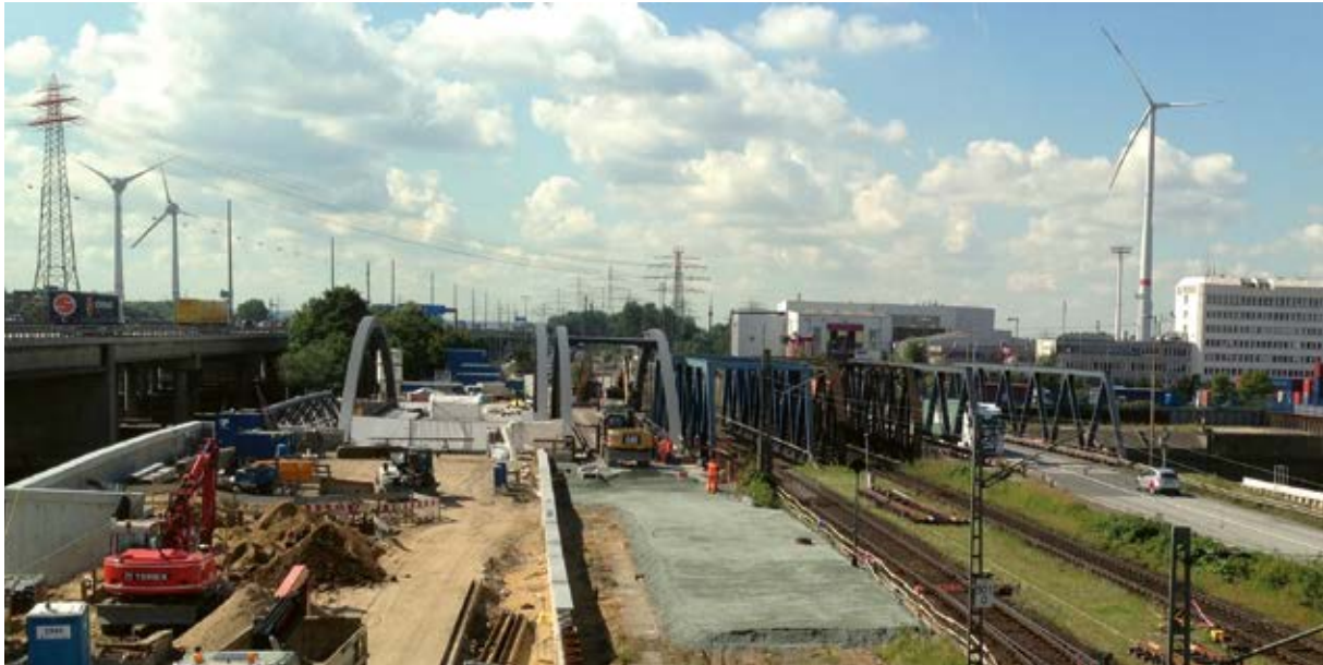
Bild 5 Bauphase 1: Die Überbauten der neuen östlichen Straßenbrücke und der neuen 1-gleisigen Bahnbrücke sind bereits eingehoben. Foto: Anja Vogl / HPA
