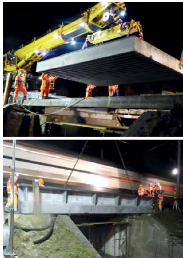
Bild 10 Versetzen der vorfabrizierten UHFB-Rippenplatte und des Randträgers (bei Zugdurchfahrt auf dem benachbarten Gleis) auf die Widerlager
