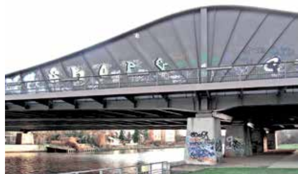
Bild 16 Die Sichtbeton- und Stahlflächen bei den Brücken (hier die Havelbrücke in Berlin Spandau) sind vor wildem Graffiti kaum wirksam zu schützen.
