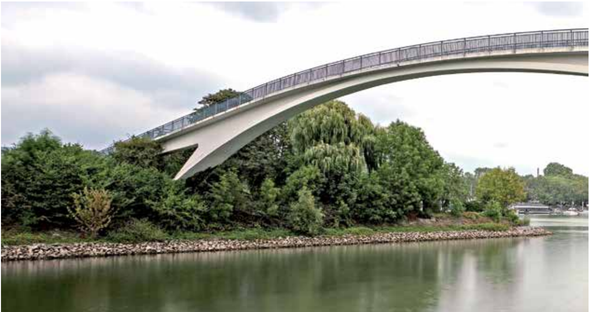
Bild 17 Der nördliche Auflagerbereich und die Rampen des Dyckerhoff-Stegs sind durch kleine Bäume und Unterholz überwuchert. Foto: Dicleli (2019)
