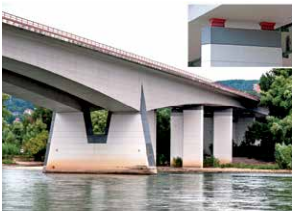
Bild 15 Auch bei der Rheinbrücke Bendorf haben die Verantwortlichen keine Bedenken gehabt, das Bauwerk mit neuen farbigen Applikationen zu schmücken.
