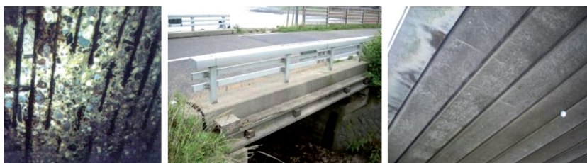
Bild 6 Unterseite der alten Shinmiya-Brücke aus Stahlspannbeton nach 20 Jahren Nutzung (links); neue Brücke aus Carbonspannbeton nach 20 Jahren Nutzung (Mitte und rechts) Fotos: [36]
