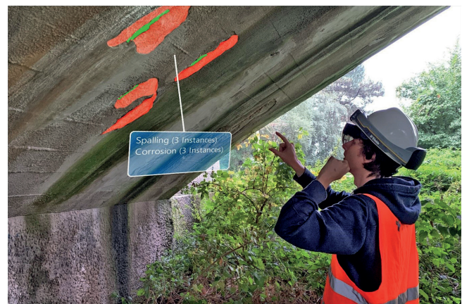
Bild 1: Schadensvisualisierung mittels AR
