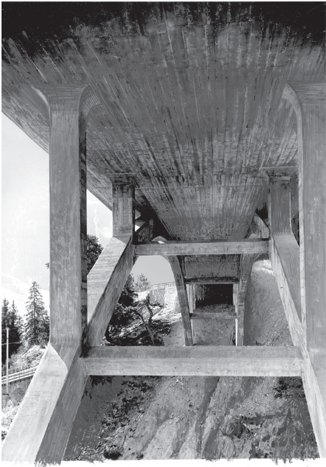
Bild 16: Laxgrabenbrücke in Lax (Furkastraße), 1942; hier Foto der Pilzdecke für eine Publikation Büro A. Sarrasin (Archiv Ph. M.)
