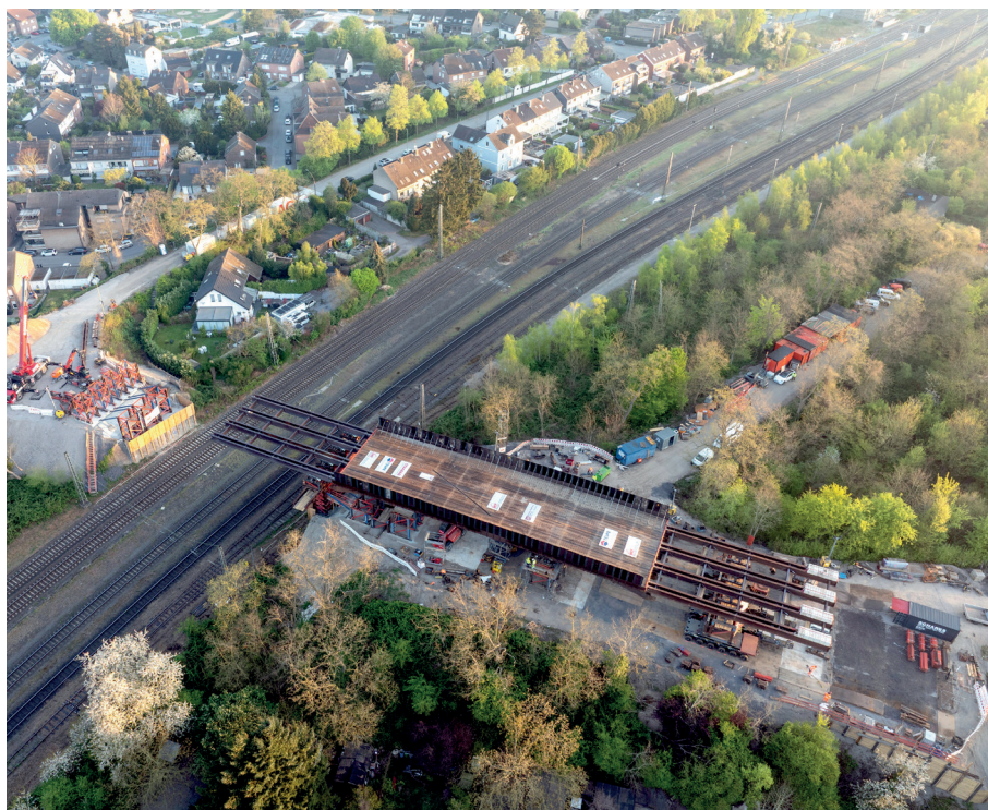
Bild 1: Gesamtansicht des Überbaus zu Beginn des horizontalen Verschiebens inklusive Vorbau- und Nachlaufschubel; die Bati-Türme sind bereits mit einer Rückverankerung gegen horizontale Lasten ausgesteift
