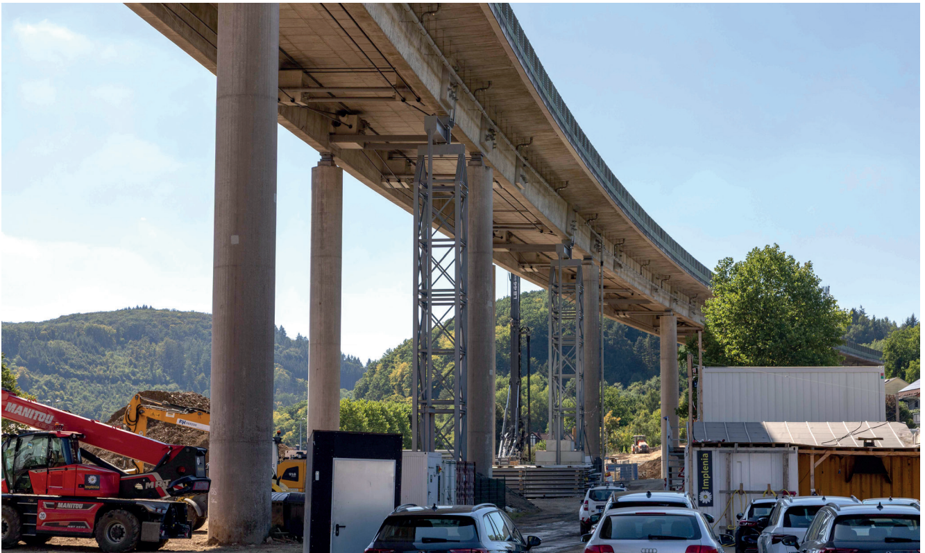
Bild 5: Am Limit: die alte Talbrücke Sechshelden
