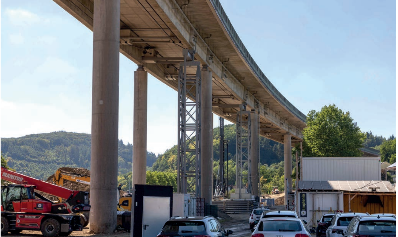
Bild 5: Am Limit: die alte Talbrücke Sechshelden
