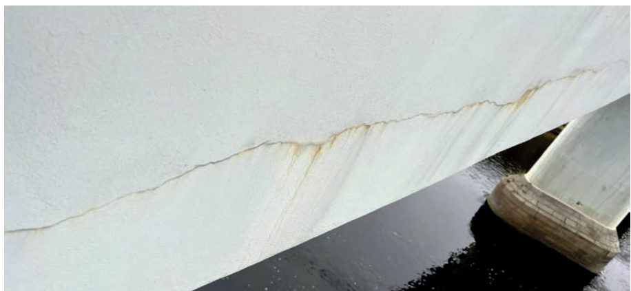
Bild 5: Längsriß mit Rostfahnen an einer Seite des Unterspannbandes
