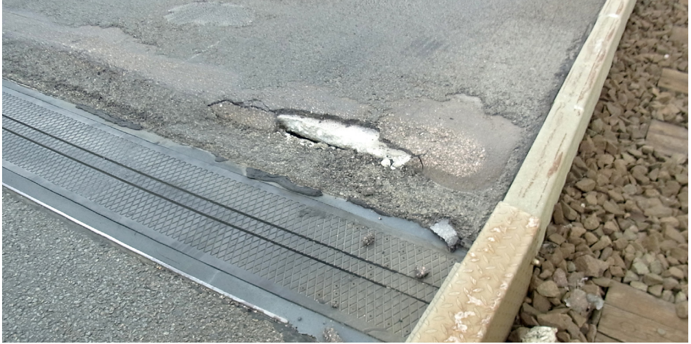
Bild 4: Belagschaden vor FÜK
