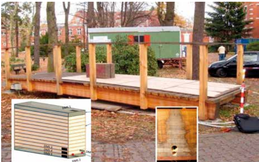
Bild 10: Brettschichtholzträger auf dem Testgelände der Bundesanstalt für Materialforschung und -prüfung (BAM) mit Schädigung durch zwei Bohrlöcher Foto: Hofmann, Brandes
