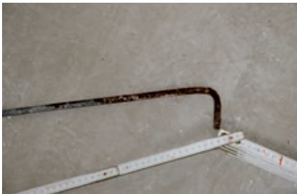
Bild 7: Bewehrungseisen aus der historischen Rippendecke
