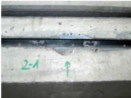
Bild 8: Abplatzen von Betonresten an den Lippen der Halfenschiene Foto: HOCHTIEF
