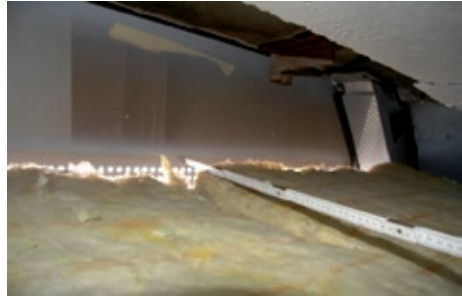
Bild 5: Von Mineralwolle teilweise verdeckte Einströmöffnungen für die Hinterlüftung des Kaltdachs Foto: Peter Bauer
