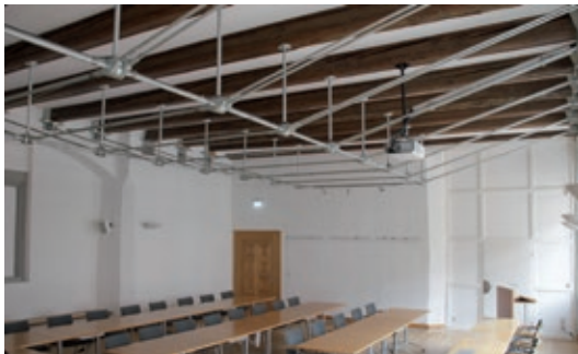
Bild 1: Unterspannung der Decke im Ratssaal Pirna, aufgenommen im Sommer 2014
