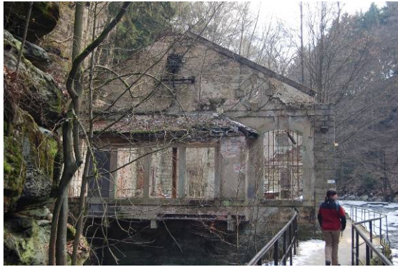
Abb. 25: Verfallenes Wasserwerk an der Wesenitz im Liebethaler Grund
