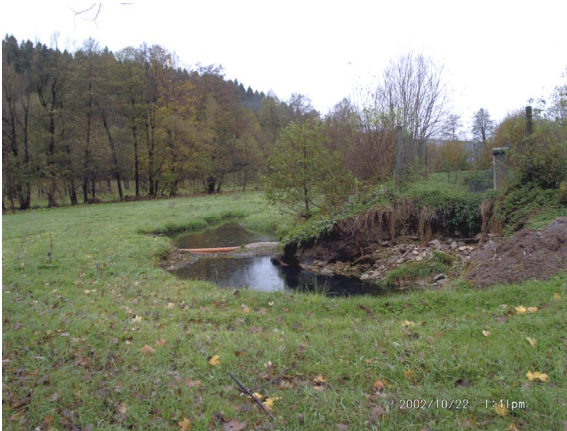
Abbildung 19: Beschädigung des Auslaufbauwerks
