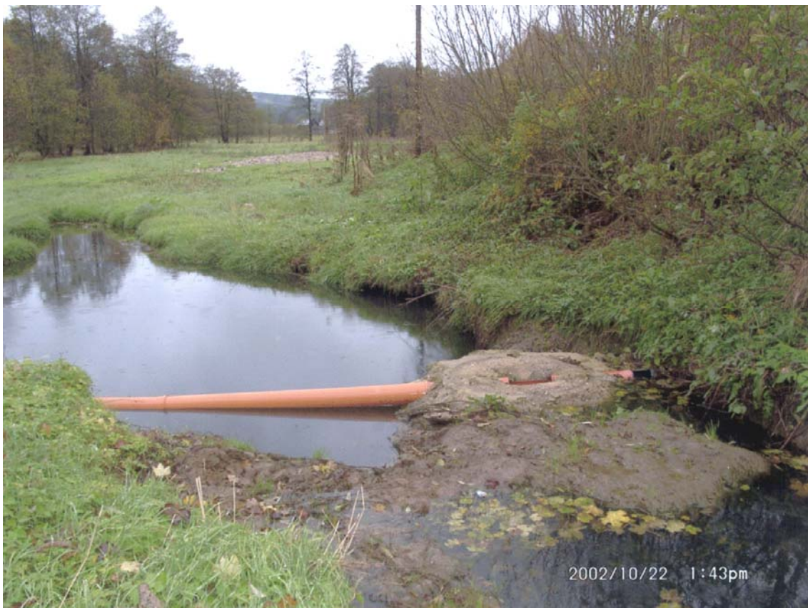
Abbildung 20: Beschädigung des Auslaufbauwerks
