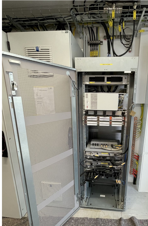
GSM-R-Standort im NOKIA-Indoorschrank in Betonschaltheus
