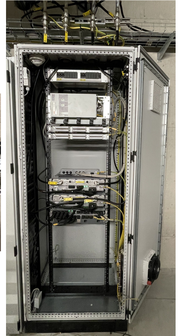
GSM-R-TK-Raum Tunnel im Rittal-Schrank (staubgeschützt nach IP54)
