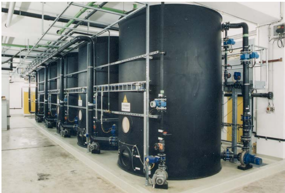
Der Rieselstromreaktor im Einsatz bei der BEWAG in Berlin
