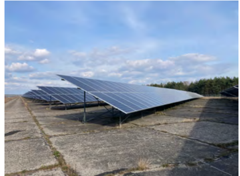
LEAG's Solarpark in Flugplatz Welzow
