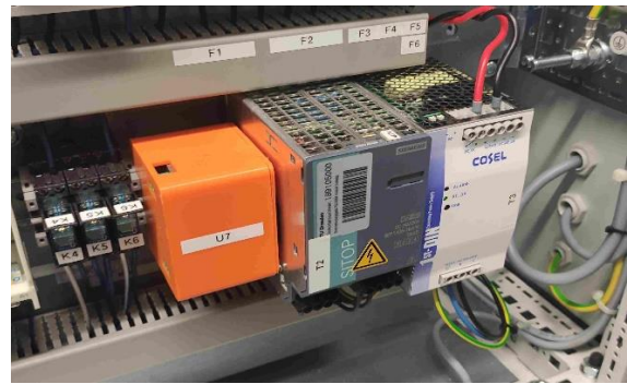
Abb.: Verursacher von EMV-Störungen: Typische 24V-Schaltnetzteile in Schaltschränken.
