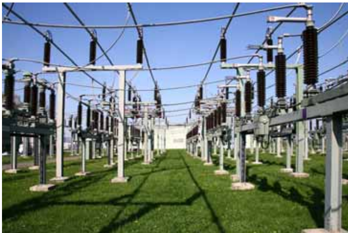
Dresdner Umspannwerk (Quelle: DREWAG)
