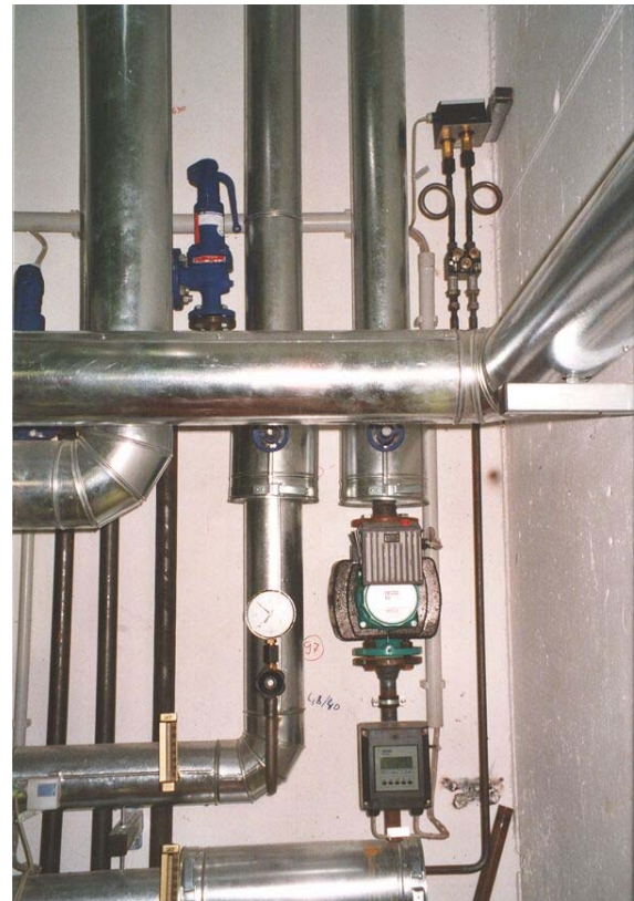
Abbildung 58: Ausrüstung im Kollektorkreis
