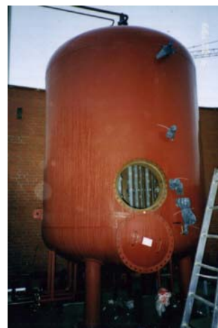
Abbildung 13: Wärmespeicher vor dem Isolieren
