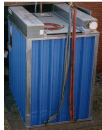
Abbildung 15: Eisspeicher bei der Anlieferung
