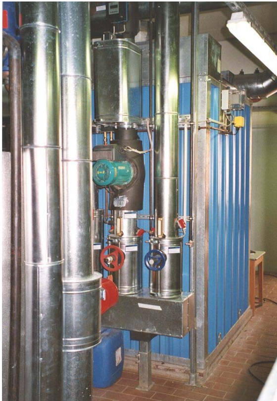
Abbildung 57: Eisspeicher und Kälteverteiler
