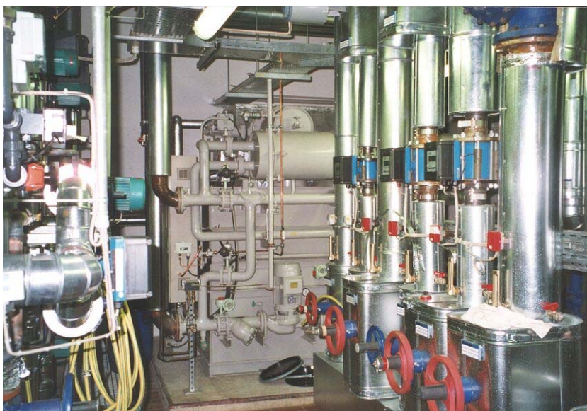
Abbildung 56: AdKM im Hintergrund, Teile der Meßausrüstung rechts
