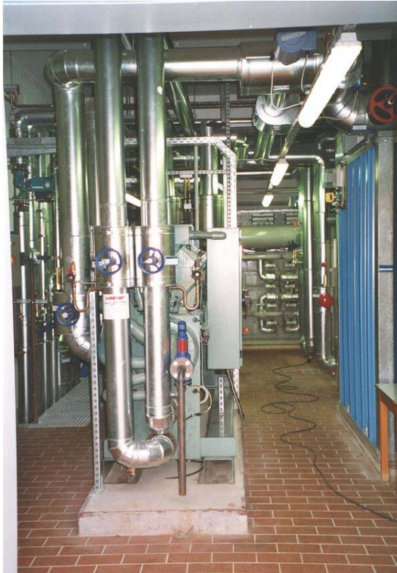
Abbildung 54: Blick in die Kältezentrale AdKM im Hintergrund, Eisspeicher rechts, KKM links
