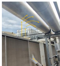
Abb. 3: Abluft gelangt vor die Verflüssiger
