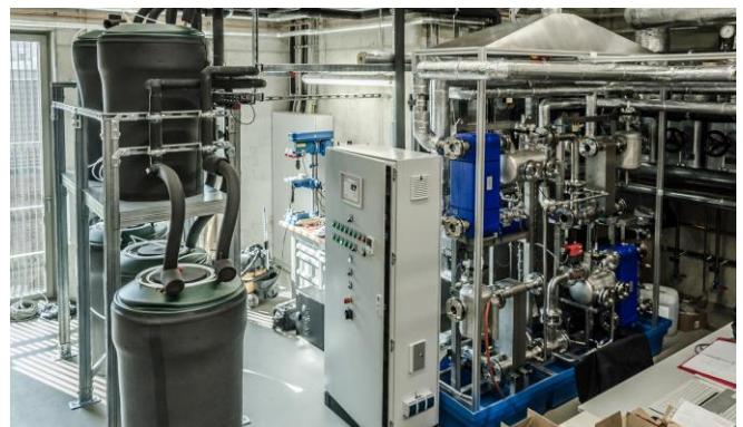
25 kW Resorptionsanlage mit Eisspeicherverbund
