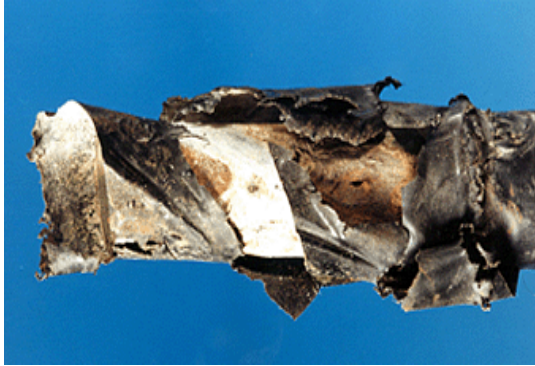
Trinkwasserrohr aus verzinktem Stahl http://www.korrosion-online.de
