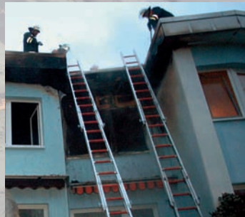
Absturzgefahr! Brandbekämpfung auf dem Flachdach
