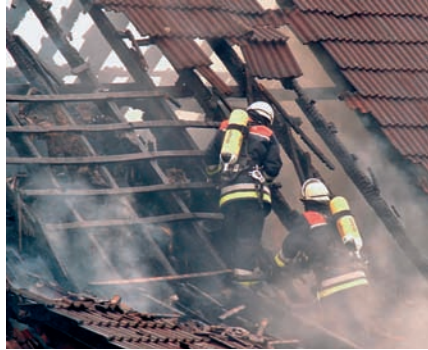
Gefahr! Die Dachkonstruktion ist nicht mehr sicher begehbar. Es besteht Durchbruchgefahr durch angebrannte Dachlatten.
