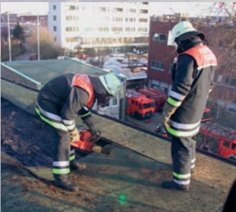
Durchbruch- und Absturzgefahr! Einsatzmaßnahmen auf unsicherer Standfläche unmittelbar an der Absturz- kante des Flachdaches
