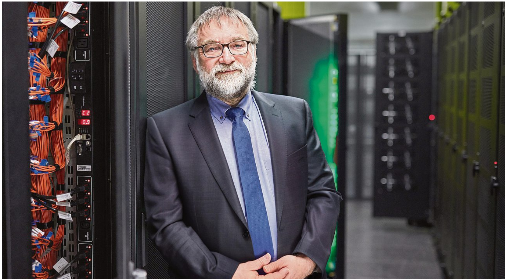
Unscheinbarer Raum, aber voller Leistung: Im neuen Rechenzentrum werden riesige Datenberge für zukunftsweisende Anwendungen genutzt. Prof. Wolfgang Nagel ist der Hüter des Superrechners.
