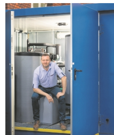
Oliver Ziegler vor der Kältemaschine der TUD.
