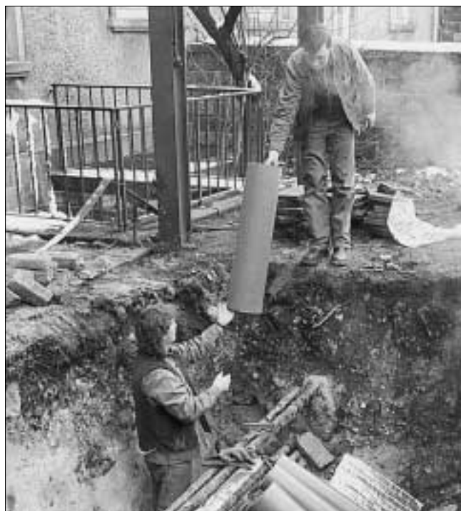
Jens Wünsche (l.) und Frank Ebert von der DEF reparierten vorige Woche ein 125er Heißwasservorlaufrohr an der Haackelstraße. Die gerissene Schweißnaht hätte fast dem gesamten Physikbau arktische Temperaturen beschert. Foto: UJ/Eckold
