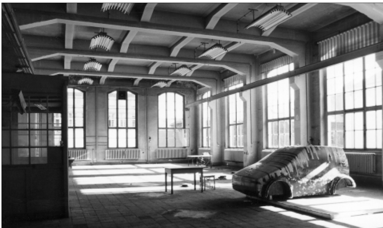
Die SPEZ-GmbH wird die Infrastruktur des Institutes für Produktionstechnik nutzen. Nach Rekonstruktion und Sanierung, wie unser Foto zeigt ist dies dringend notwendig, wird sie auch im Sachsenberg-Bau arbeiten. Foto: UJ/Eckold
